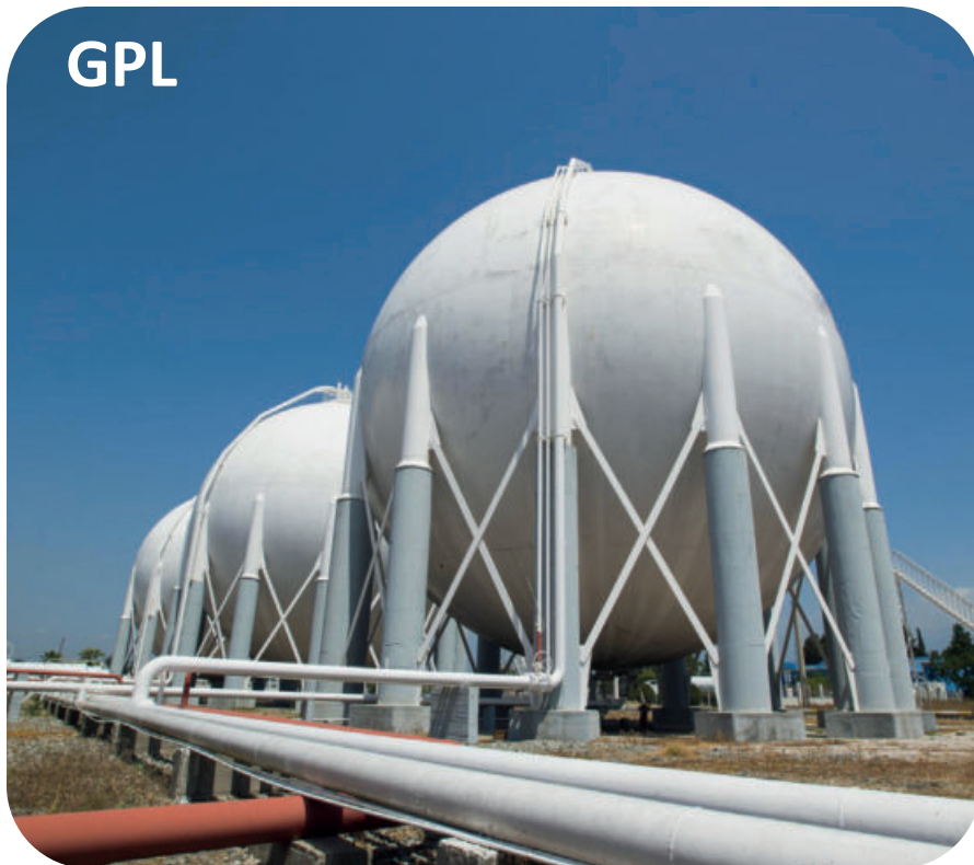
Cisterne di gas di petrolio liquefatto (sulzer.com)
